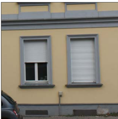
Neue Promenade 29: Die Rollladenkästen wurden nicht sichtbar eingesetzt.
