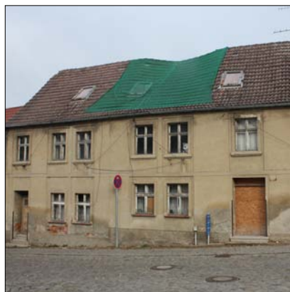
Die Königstraße 45 ist gesichert. Weitere Maßnahmen sind zum dauerhaften Erhalt erforderlich.
